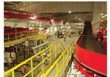
DHL Control Asia Hub Expansion - Steelwork Fabrication & Equipment Installation DHL 空運中心擴建 - 鋼結構製造及設備安裝
